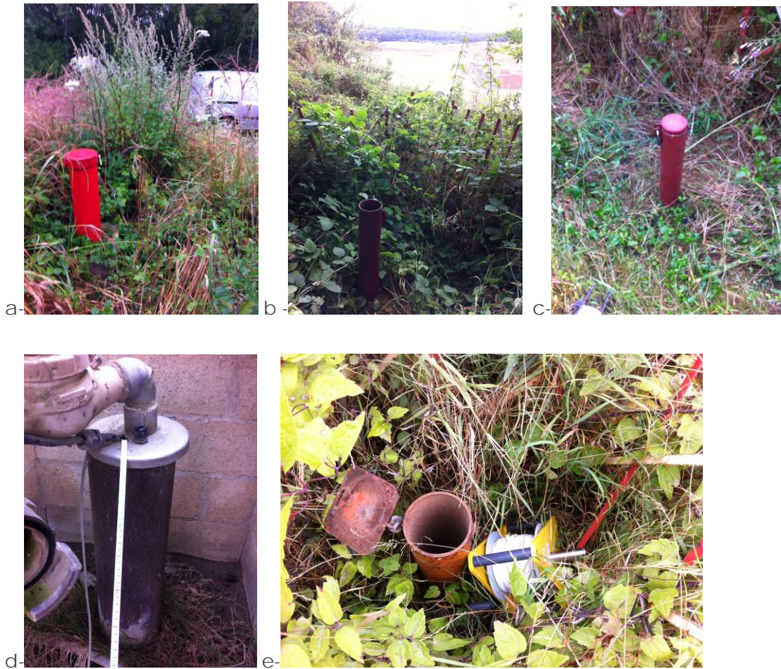
Figure 2 : Ouvrages du réseau de surveillance du site : a- PZ4ac ; b-PZ2 ; c-PZ3 ; d-PZ1 ; e- PZ3ac (IDRA – 2016)
